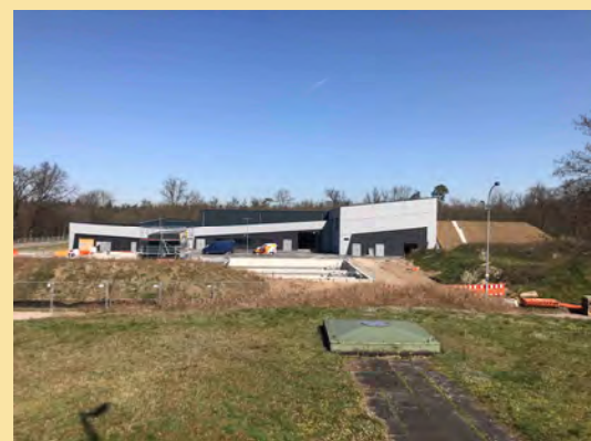
Außenansicht des Wasserwerkes Mörscher Wald
