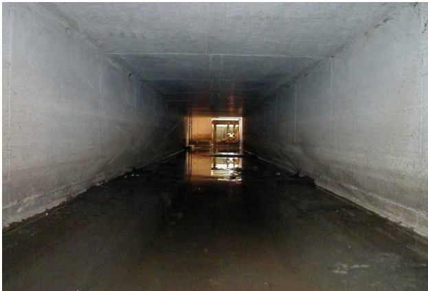
Unterirdisches Regenrückhaltebecken Mastweide
